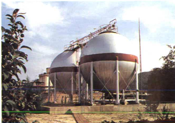
庆阳石油化工厂液化气贮罐
