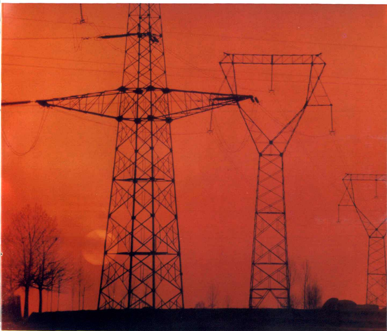
330 千伏输变电线路(什社段)
