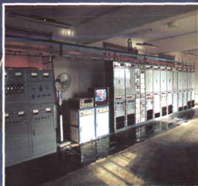
庆阳地区电视转播机房
