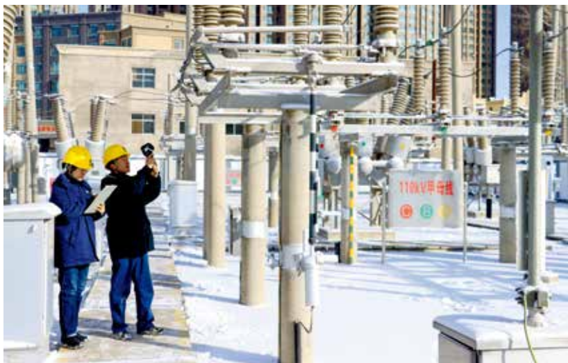
图41 2023年12月,国网武威供电公司工作人员巡视检查高压输电线路、供电线路及变电站 (王雁 摄)
