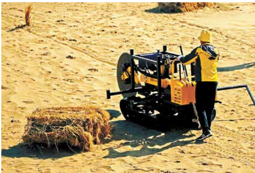
图 64 2023 年 10 月,凉州区邓马营湖区集中压沙点,工人在操作履带式压沙机进行开沟作业 (包雨纯 摄)
