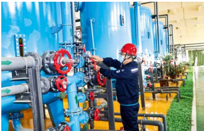
图 38 2023 年 11 月,亿利洁能科技(武威)有限公司车间,工人查看压力容器 (董丽俊 摄)
