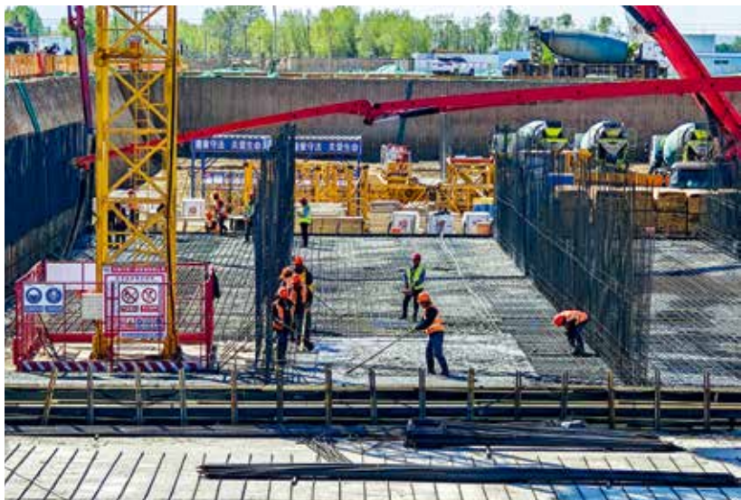
图 63 2023 年 4 月,凉州城区污水处理厂项目施工现场。该项目是全市在建最大的污水处理厂 (马艳 马晓宇 摄)
