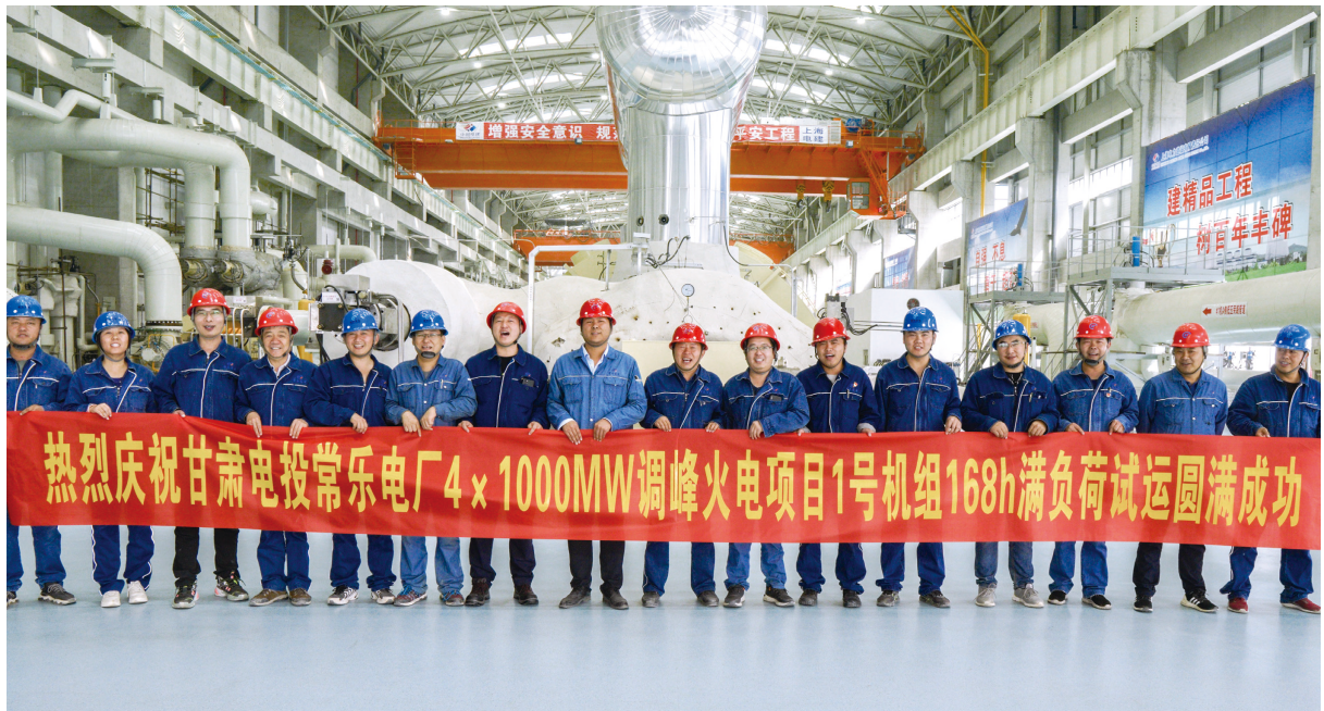
甘肃电投常乐电厂 4×1000MW 调峰火电项目 1 号机组 168 小时满负荷试运行圆满完成， 正式投产发电
