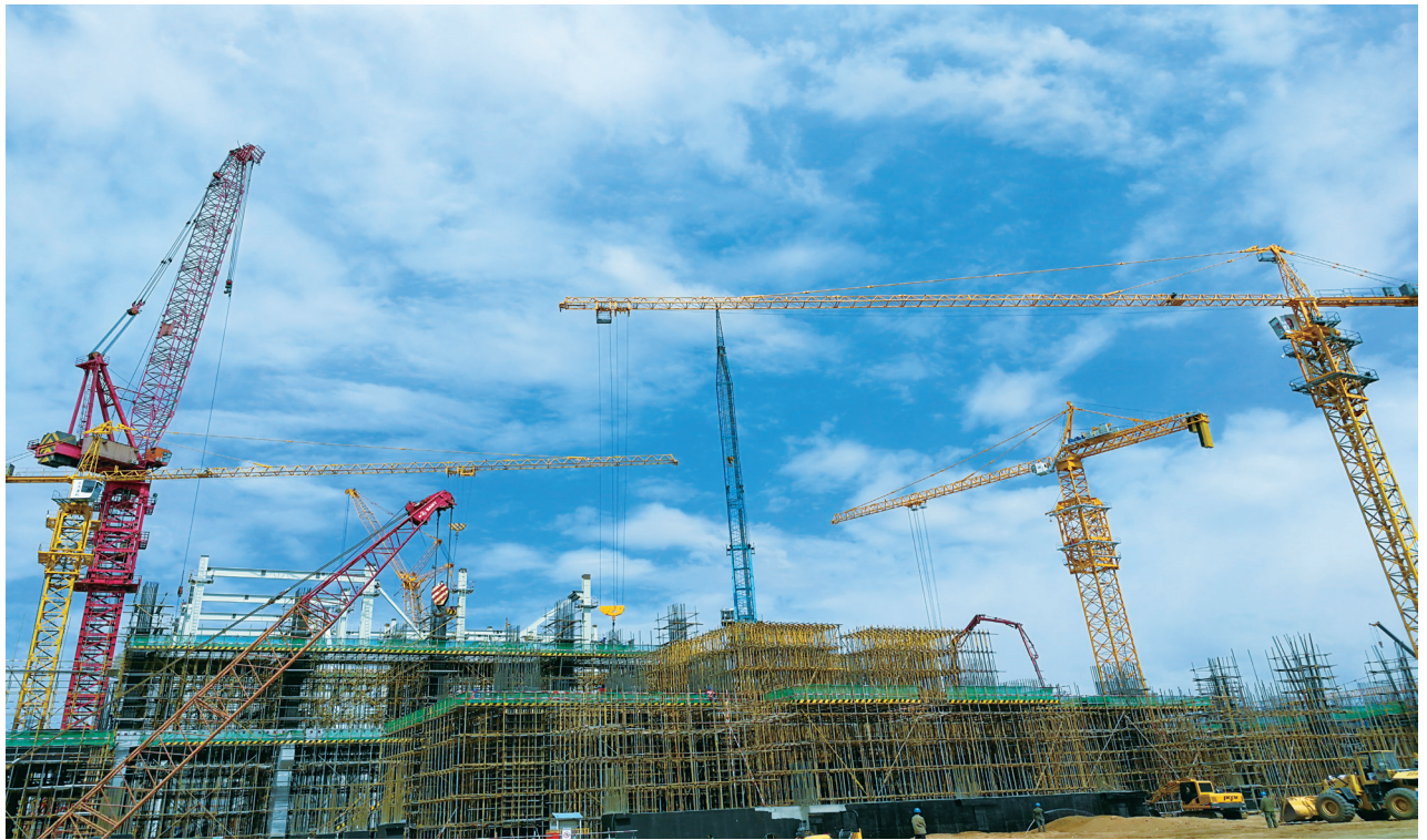
2017年9月8日 甘肃电投常乐电厂4×1000兆瓦项目开工建设动员大会在瓜州县柳沟综合物流园区举行，西北地区首个百万千瓦级调峰火电项目开工。
