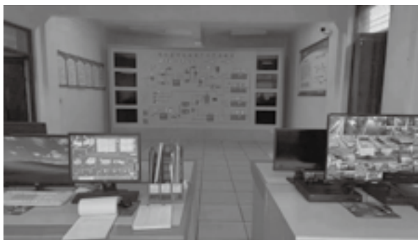
污水处理厂日常生产监测
