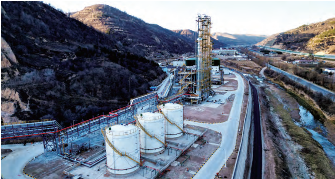
▲ 华池县绿源油气回收利用分离厂项目
