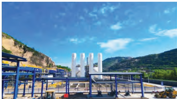
绿源石油伴生气回收分离厂
