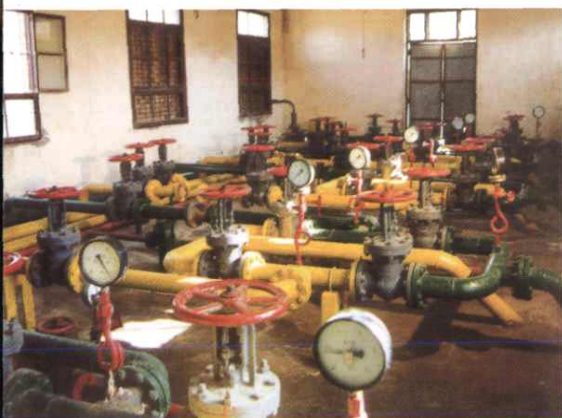
盐矿采卤控制室
