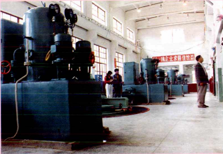
新建老虎咀电站
