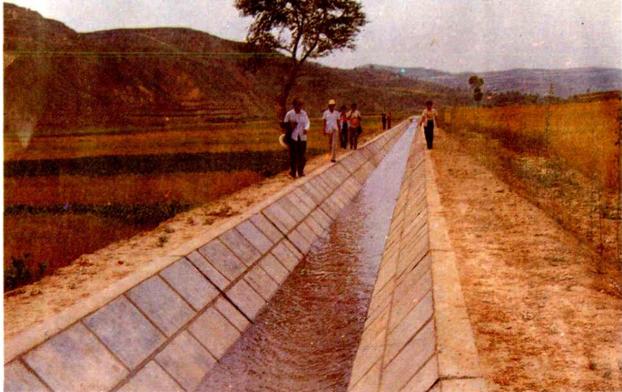
万亩灌区——横渠干渠
